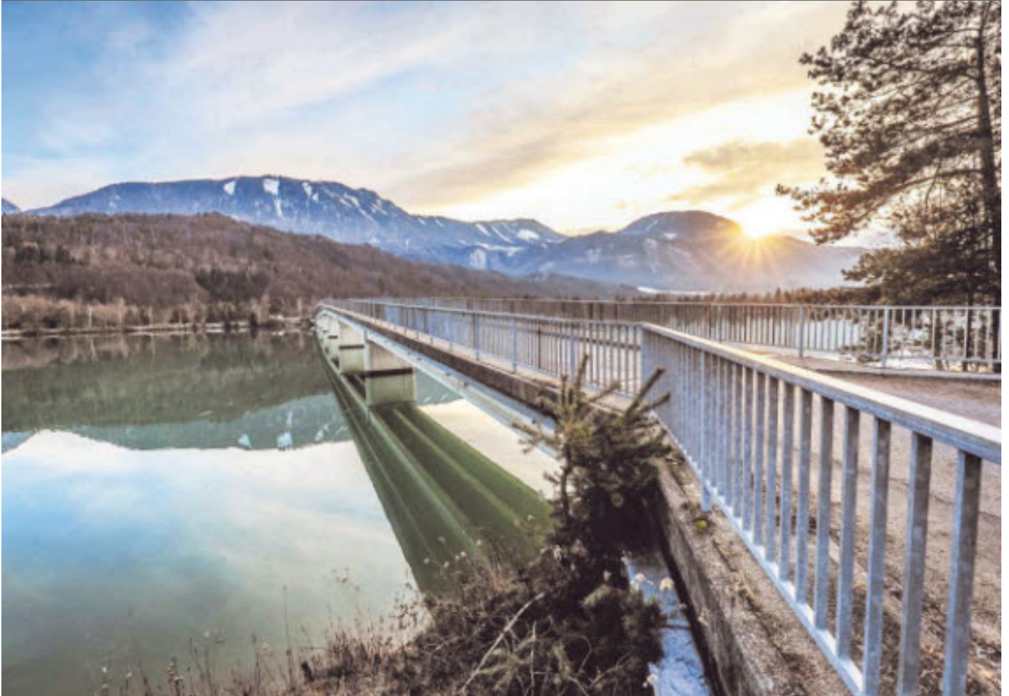
Die Fahrbahn der alten ÖDK-Brücke zwischen Ebenthal und St. Margareten ist sanierungsbedürftig
