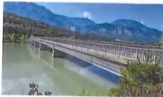
Die Draubücke, die St. Margareten im Rosental und die Gemeinde Ebenthal verbindet, ist sanierungsbedürftig.
